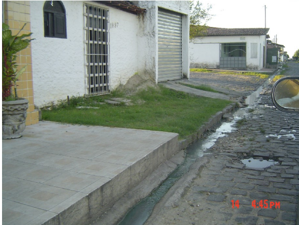
FIGURA 48. Lançamento de água servida em via pública na Rua João Felipe Santiago.
