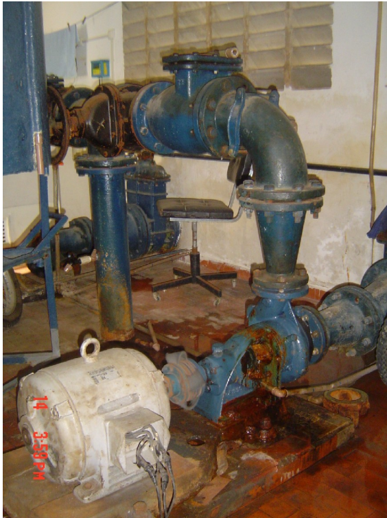
FIGURA 18. Estação Elevatória de Água Tratada (EAT 01).
