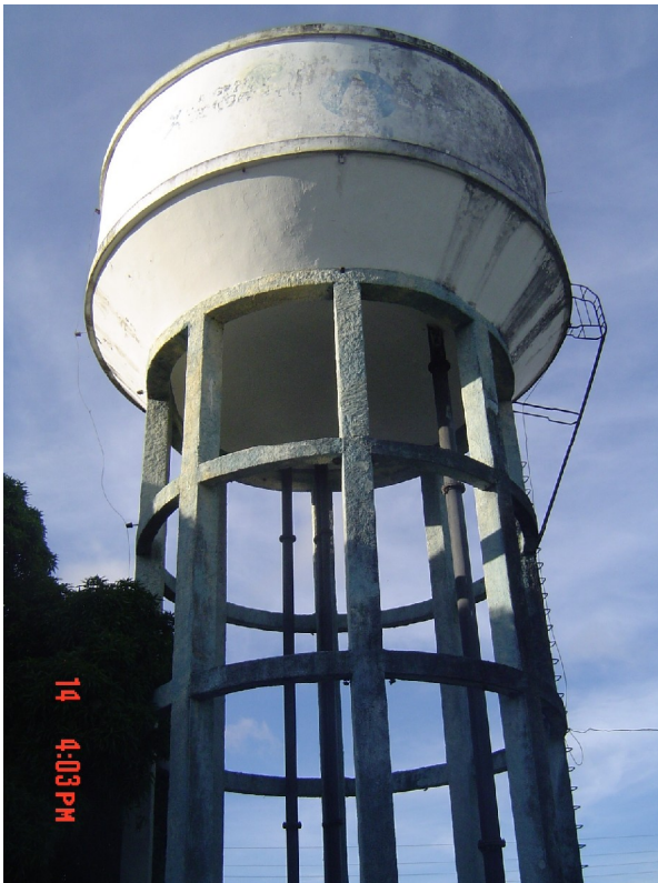
FIGURA 15. Reservatório Elevado RE-01.
