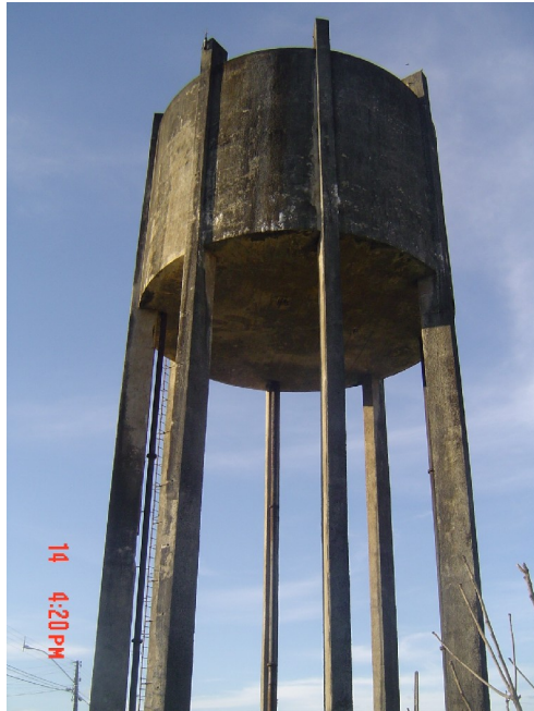
FIGURA 17. Reservatório Elevado RE-02.
