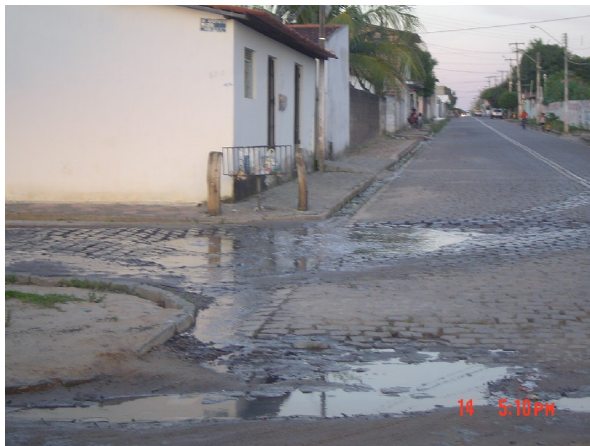
FIGURA 50. Ponto de acúmulo de água pluvial e lançamento de água servida em via pública, Conjunto Agnelo Alves.
