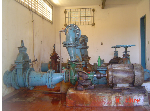
FIGURA 19. Estação Elevatória de Água Tratada (EAT 02).
