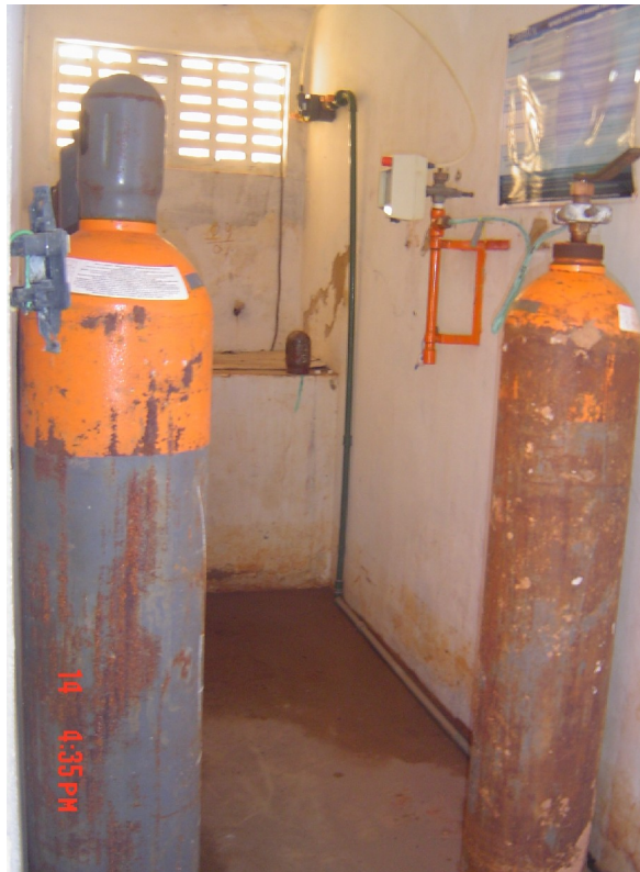
FIGURA 12. Aplicador de cloro gasoso injetado no Reservatório Apoiado RA-02.
