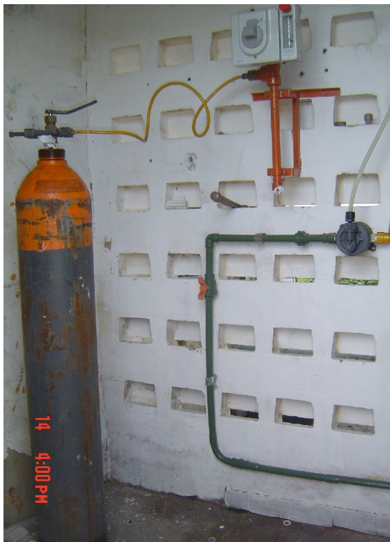
FIGURA 11. Aplicador de cloro gasoso injetado no Reservatório Apoiado RA-01.
