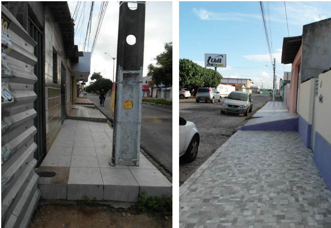
Figura 10. Descontinuidades no passeio público – calçadas com desníveis - exemplos
