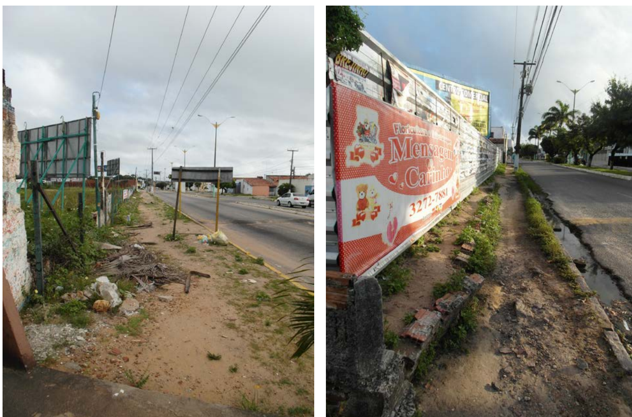
Figura 9. Descontinuidades no passeio público – calçadas sem pavimento - exemplos
